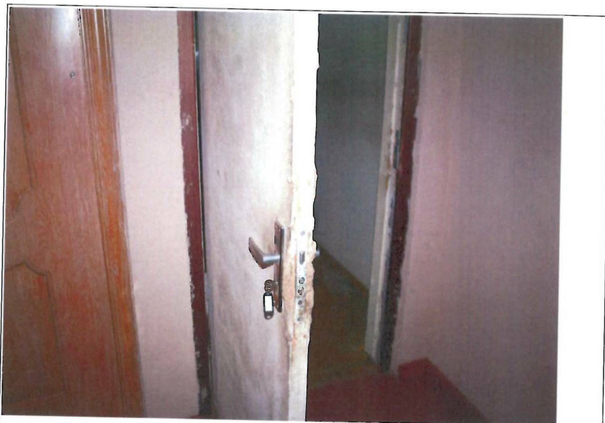
Foto Nr. 8. Ārdurvju bojājumi.
