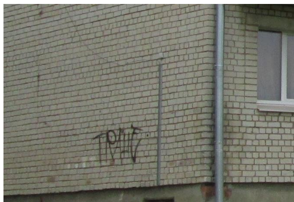
2.12.b attēls. Temperatūras sensors uz ēkas fasādes
